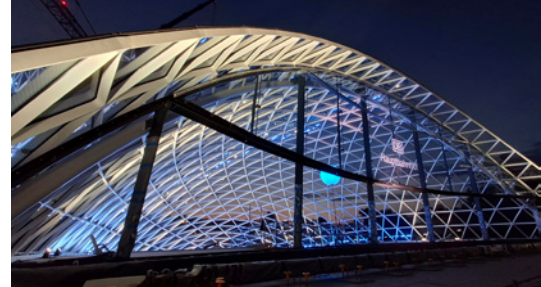
Die sog. Gitterschalen, insgesamt vier an der Zahl, überdachen die Zugänge zum künftigen Stuttgarter Hauptbahnhof.
