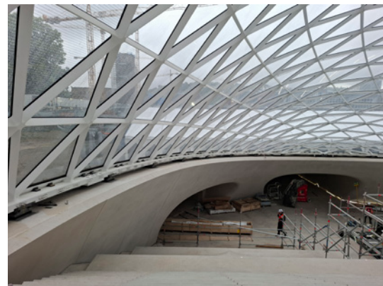
Blick von innen auf die „Füßchen“ der Gitterschale: Gut 2 Dutzend Kalottenlager tragen die Stahl-Glas-Konstruktion, erlauben teilweise dreidimensionale Bewegungen und nehmen an zwei Lagern Horizontalkräfte auf.
