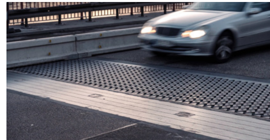
Übergangskonstruktion unter Verkehr. Die Rauten mindern Überfahrgeräusche.
