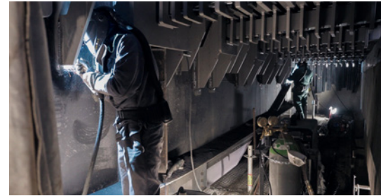
Anschweißen der neuen MSM®-Schwenktraverse an die rheinseitige Stahlbrücke. Oben im Bild zu sehen die Schwenktraversen, auf denen die obenliegenden Profile lagern.
