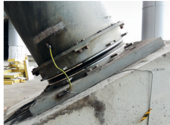
Eines der acht Pylonlager: Sie sind bei einem vergleichsweise geringen Durchmesser von 1.600 mm für eine große Verdrehung von \pm 0.025 rad sowie für eine enorme Auflast von ca. 10.000 to ausgelegt.
