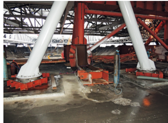
Insgesamt 60 Druck-Zug-Kalottenlager wurden unter der Tribüne verbaut. Bereits für den Bauzustand und auch den Endzustand waren Zuglasten von -3,5 MN zu berücksichtigen.
