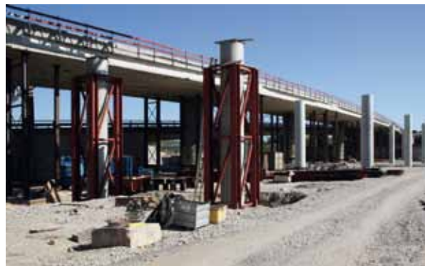
4 Hochbrücke Freimann an der BAB A 9; temporäre Stützen für die Lagermontage © Maurer Söhne GmbH & Co. KG
