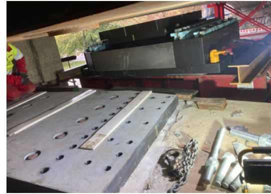
Herausforderung beim Einbau: Extrem enge Raumsituation. Das Lager mit seinen 73 cm Höhe zeigt, wie eng es für die Monteure beim Einbau war.
