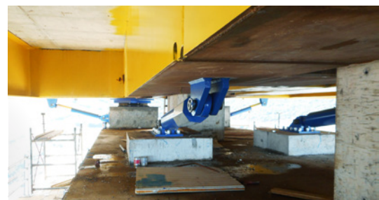
Situation auf einem der beiden Brückenpfeiler: Vorne Mitte und rechts zwei Hydraulikdämpfer in Querrichtung, links dahinter ist eines von vier Gleitpendellagern sichtbar, dahinter außen zwei Längs-Hydraulikdämpfer.
