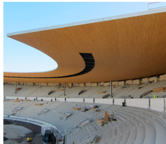
Die sanierten Tribünen mit dem neuen Dach. Die Stahlstützen in den Sitzplatzreihen tragen die Hauptlast. Unterm Dach liegen die 84 kleineren Lager, die vor allem die Zugbelastung aufgrund des auskragenden Dachgewichts aufnehmen.
