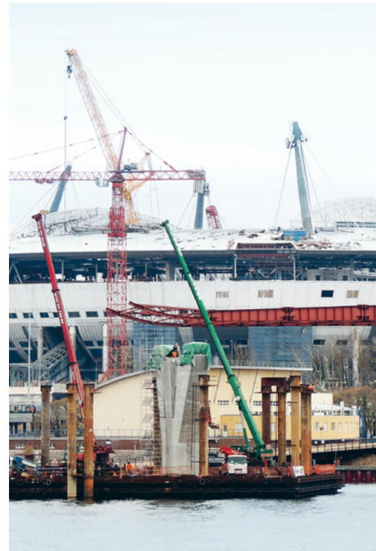
Baustelle Zenit-Stadion direkt an der Newamündung: Trotz des Gewirrs der Kräne deutlich zu erkennen sind die acht Pylone.
