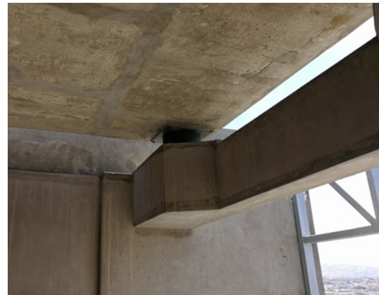
Masseplatte und Bleikernlager von unten gesehen. Foto: MAURER
