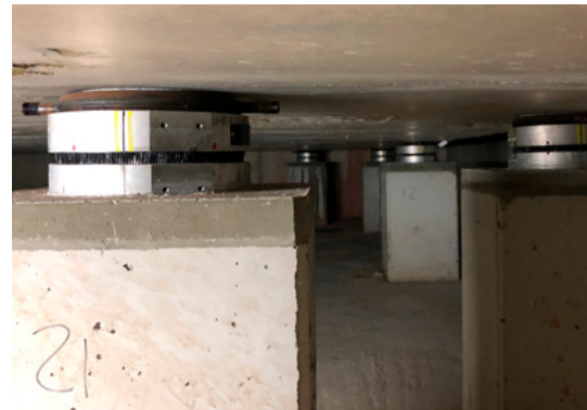
Der historische Bauernhof steht auf 45 Stützen, auf denen die Isolatoren liegen.
