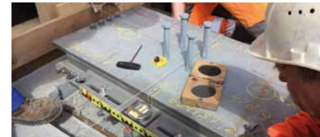
Instalación en Botlekbrug, Países Bajos
